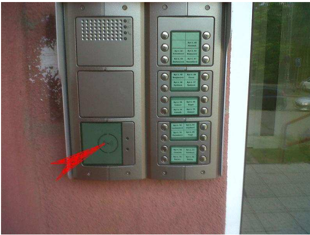
Čtečka čipů ve zvonkovém tablu hlavní vstup.
